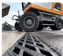
HYDROBLOCK -Entwässerungsrinne, verbaut bei einer Spedition, wo die schweren Lkws tagtäglich be- und entladen werden.
